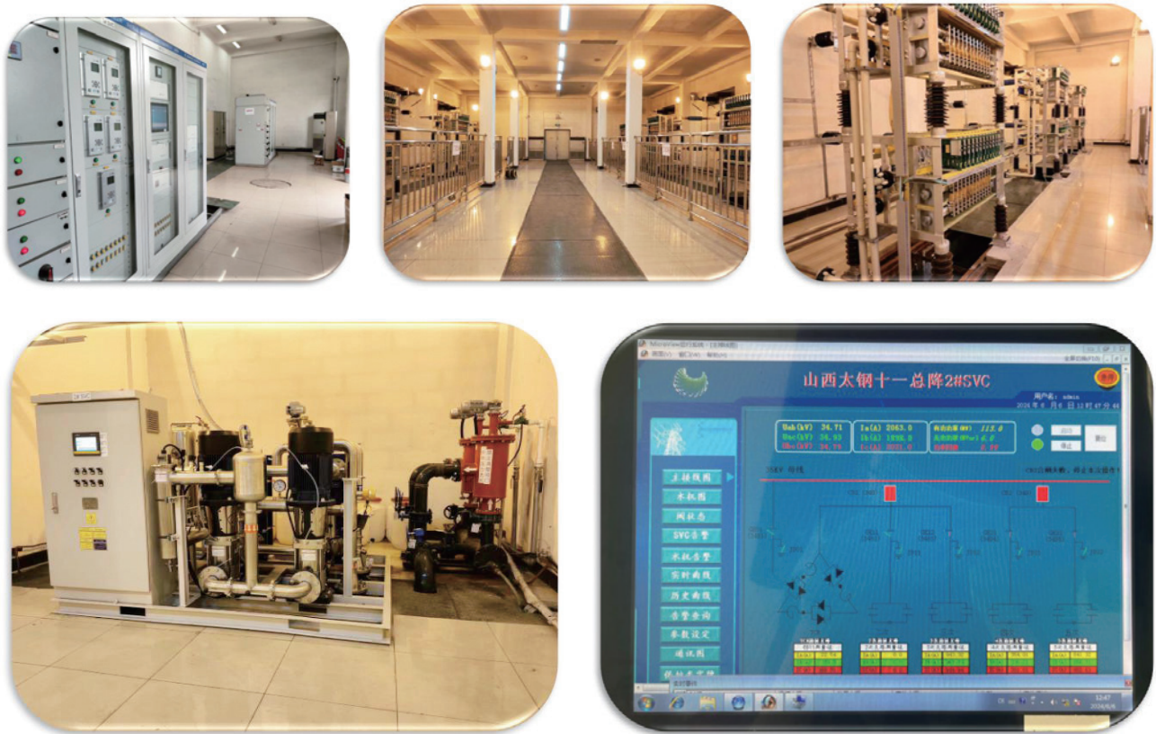
山西太钢200MVar/35kV SVC装置图
