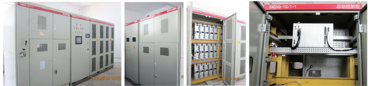
齐车10kV/8MVA SVG
