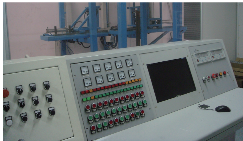
自动化高压试验室自动试验站高压电极
